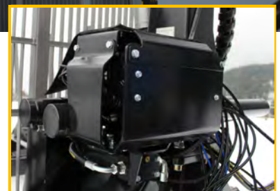
gut geschützter Steuerblock mit Druckfilter
